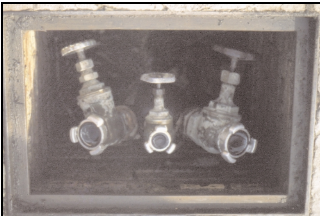
Hidrante enterrado con dos bocas de 70 y una de 45 mm.
